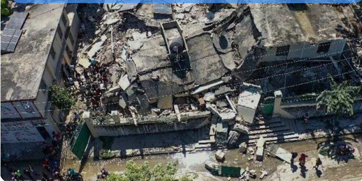
Edificios dañados y colapsados en la ciudad de Les Cayes
